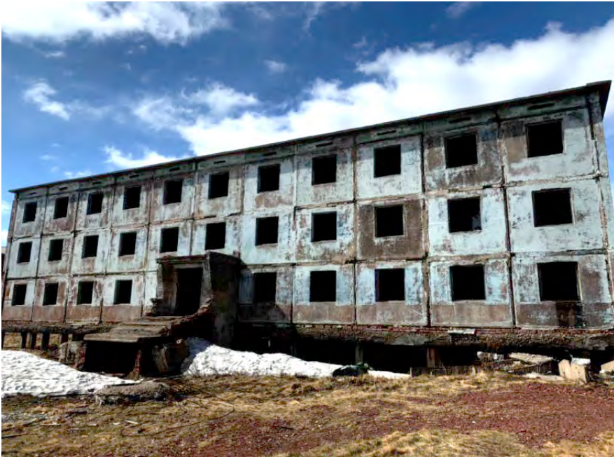
Рис. Здание в аварийном состоянии на многолетнемерзлых грунтах
