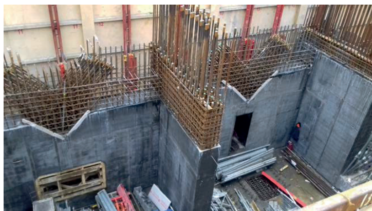
Рис. 2. Густоармированные конструкции стен ауригерных этажей Башни «Апартаменты» высотного комплекса «Нева» на участках №17-18 ММДЦ «Москва-Сити», возведенные из самоуплотняющейся бетонной смеси (расход арматуры 342-679 кг/м 3 , класс бетона В100, объем бетонной смеси 6,2 тыс. м 3 )
