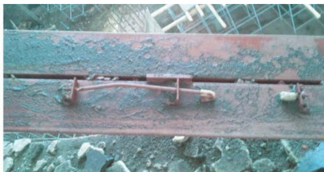
Рис. 9. Деформометр, установленный на диагональной связи, выведен из строя (погнута штанга деформометра) Fig. 9. Strain gauge installed on the diagonal brace is out of order (the rod is bent)
