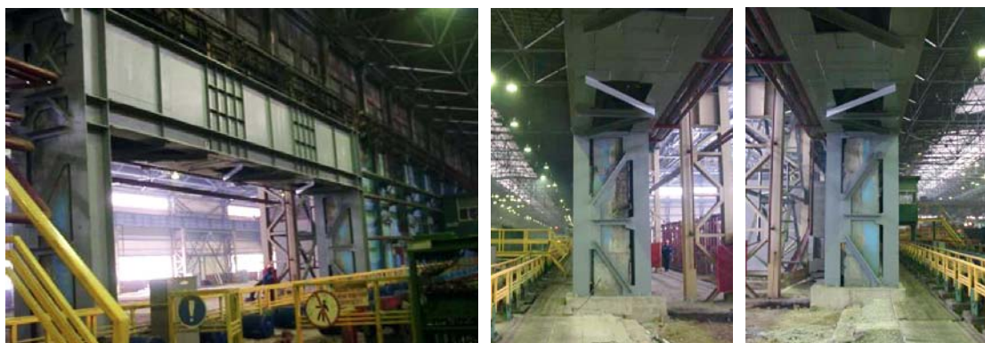
Рис. 11. Конструкция портала в месте выбитых колонн Г81 и Г82 в пролете В–Г здания ТПЦ-1
