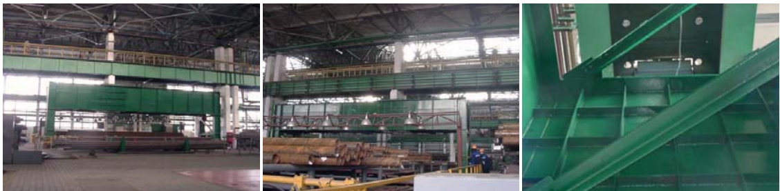
а (a) б (b) в (c) Рис. 6. Портал в здании ТСЦ-4 по ряду В в месте выбитой колонны В11: а – вид из пролета Б–В; б – вид из пролета Г–В; в – опиание на портал верхней части В11 Fig. 6. Portal in the TSTs-4 building along the B row in the location of the demolished B11 column: a – view from the Б–В span; b – view from the Г–В span; c – upper part of the B11 column, supported by the portal
