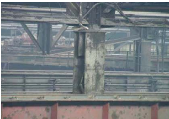
Рис. 15. Подкрановые балки портала в месте опирания оставшейся верхней части колонны Д16'
