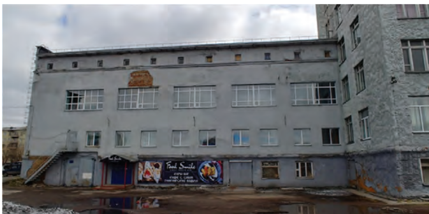
Рис.2. Дворовый фасад здания ДТДиМ с характерными дефектами (намокание материала стен, раскрытие трещин, выветривание штукатурки и материала кладки, состояние цоколя и отмостки)
