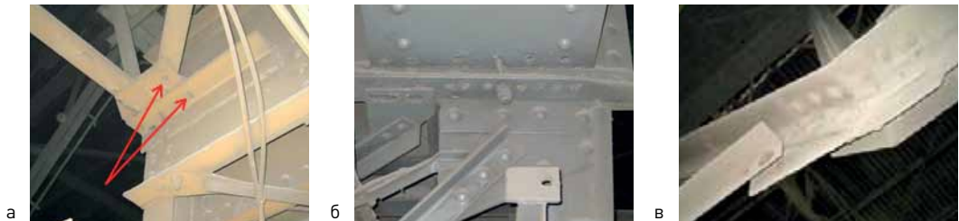
Рис.4. Срезавшиеся заклепки на колонне II/10 от оси 7 (а), на колонне II/16 от оси 19 (б) и в первом от оси 4 узле панели нижнего пояса подстропильной фермы ПФ II / 1-4 (в)
