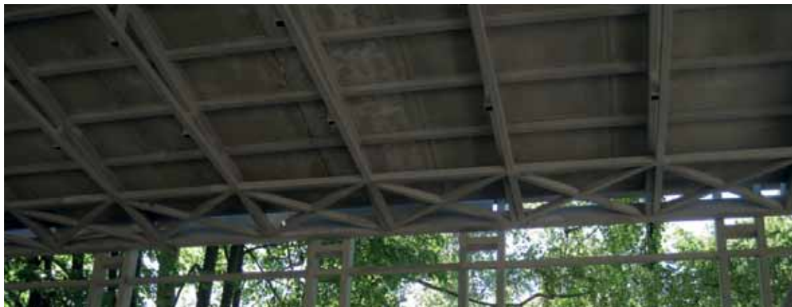
Рис.11. Опираение стропильных ферм на подстропильную балку по ряду В павильона (видны крестовые продольные горизонтальные связи)
