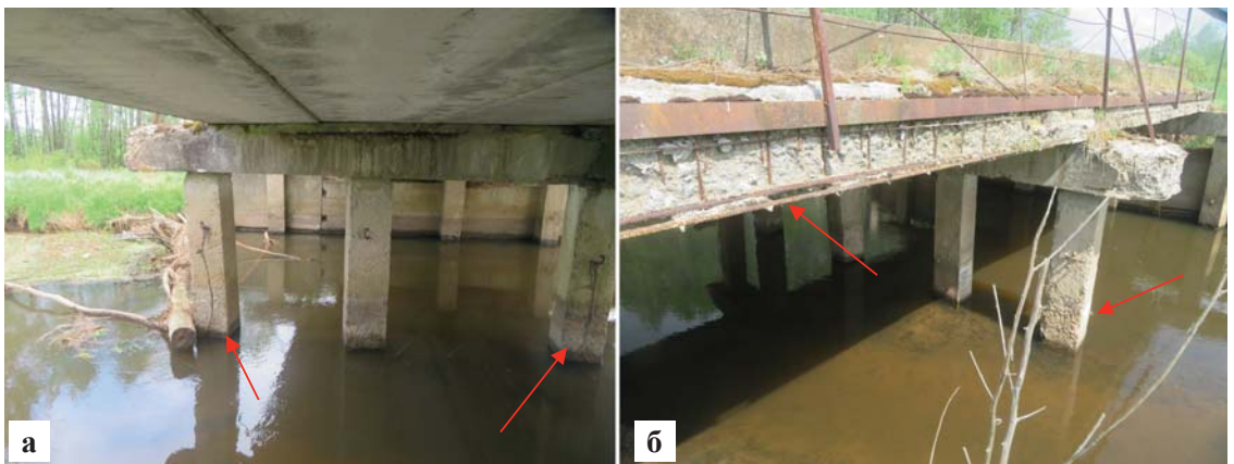
Рис. 1. Коррозионные повреждения железобетонных конструкций моста в Ивановской области: а – биокоррозия и карбонизация бетона мостовых опор; б – оголение и коррозия продольной арматуры плиты покрытия.
