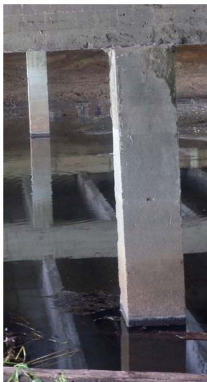
Рис. 4. Биокоррозия и карбонизация на железобетонных опорах автомобильно-дорожного моста в Ивановской области
