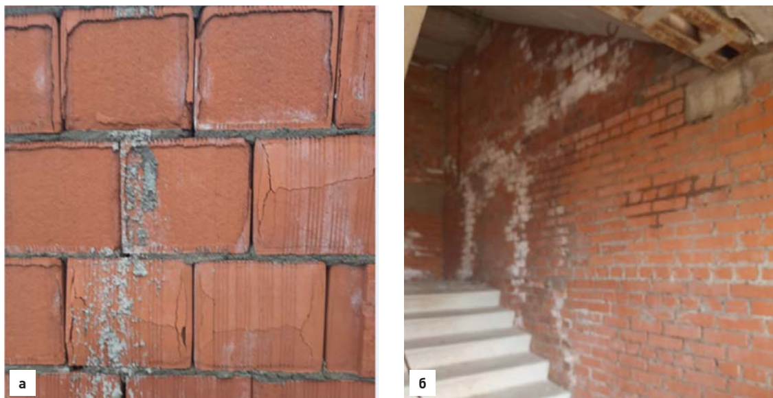
Рис. 5. Фрагменты обследования объекта незавершенного строительства: а – разрушение; б – высолы на стенах лестничных клеток
