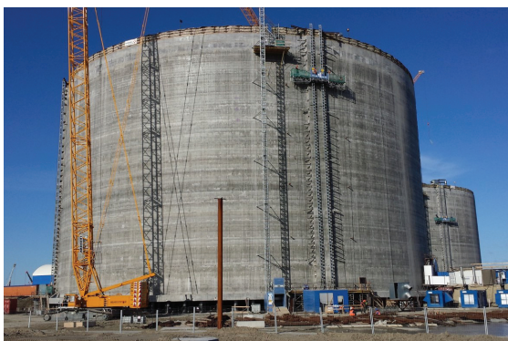
Рис. 6. Объекты топливной энергетики – резервуары для сжиженного газа
