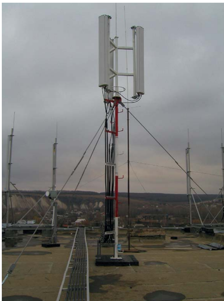
Рис. 2. Три панельные антенны на металлическом столбе на здании [2]
