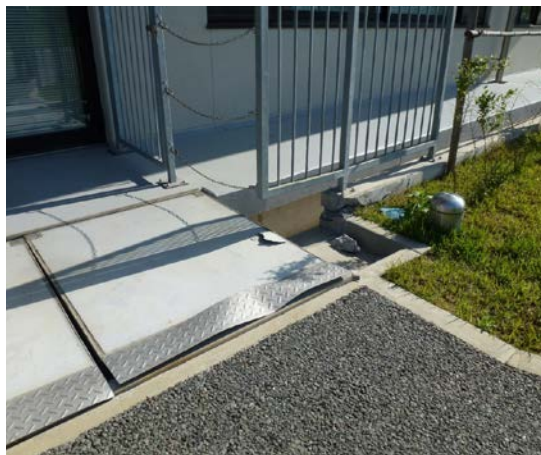
Рис. 10. Поврежденный элемент ограждения антисейсмического шва [13]
