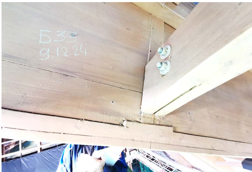
Рис. 4. Сквозные трещины усушки в стыке арки по оси 33 Fig. 4. Through shrinkage cracks in the arch joint along axis 33
