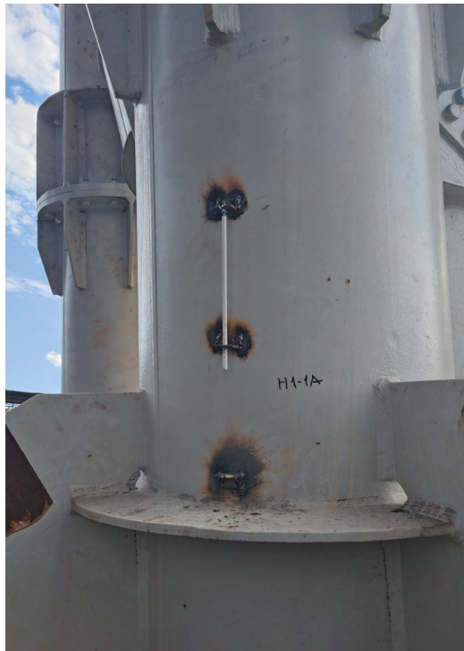
Рис. 4. Установленное приспособление под механический тензометр перед настройкой Fig. 4. Fixture installed for mechanical strain gauge before adjustment
