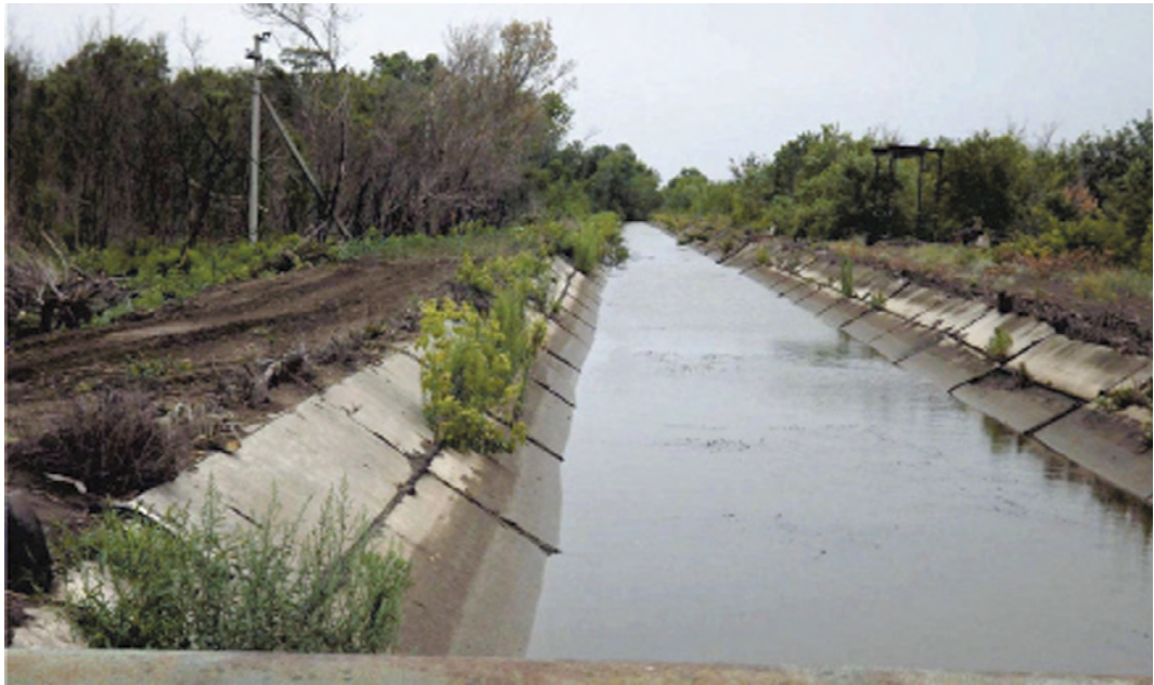
Рис. 4. Пример «продольного» расположения облицовочных плит в русле канала (Заволжская ООС). Наличие растительности в русле канала свидетельствует о нарушении сплошности покрытия канала (источник: [3])
