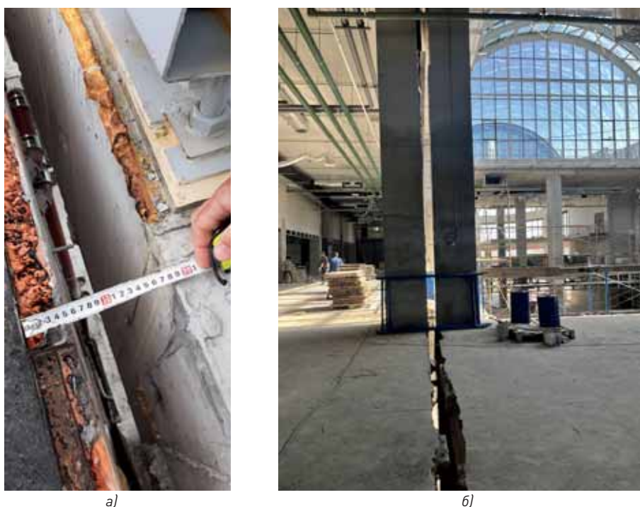
Рис. 3. Раскрытие деформационного шва на стыке между блоками № 6 и № 5. а) Замер раскрытия шва. б) Общий вид раскрытия шва между блоками
