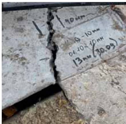
Рис. 4. Трещина в ж/б конструкции блока № 6 Fig. 4. A crack in the reinforced concrete structure of the block 6
