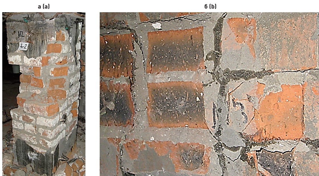
Рис. 3. Проверка проникания смолы в тело кладки: а – отсутствие следов смолы при вскрытии кладки из исторического кирпича с прочностью раствора 3,3 МПа, инъекция которой производилась при отсутствии трещин; б – распространение смолы в кладке из современного кирпича М175 на растворе М50 вдоль трещин и прилегающих растворных швах
